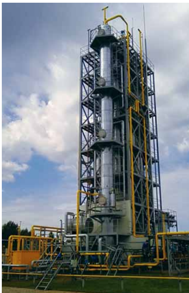
Блок очистки установки сжижения природного газа в Пскове
